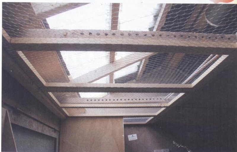
De ventilatie op de lage hokken
